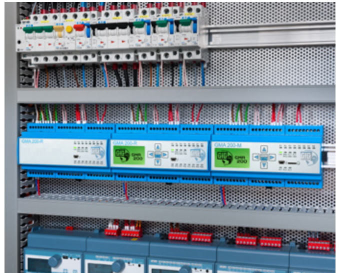
GMA200-MT avec deux modules relais GMA200-RT et GMA200-RTD montés dans une armoire électrique.
